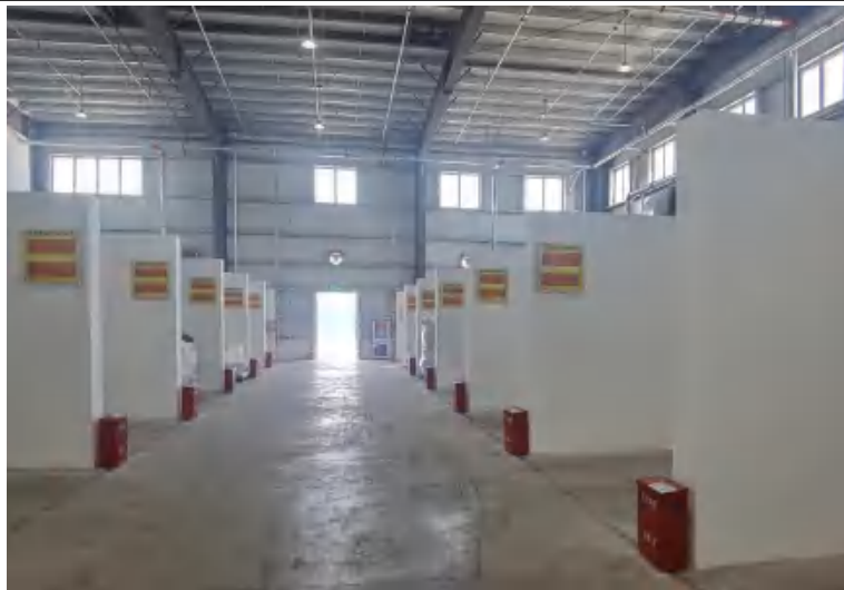
危废仓库内部（设有环氧地坪、照明、摄像头、废气收集）
