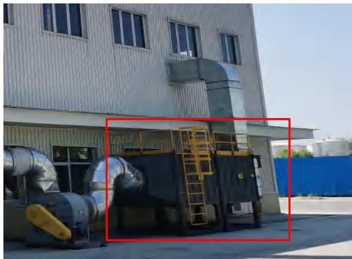
危废仓库废气活性炭处理设施
